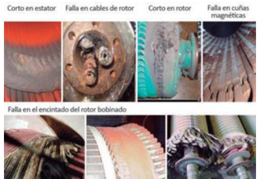
Figura 4. Fallas eléctricas en aerogeneradores.
